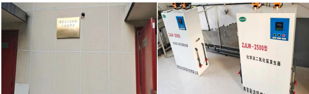
图 4-2 铜陵市人民医院 1500t/d 污水处理站实景图
