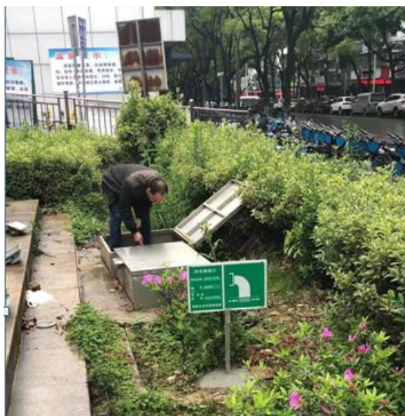
图 11-4 污水处理站总排口标志牌
