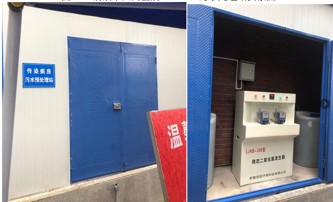
图 4-3 铜陵市人民医院传染病房废水预处理站实景图
