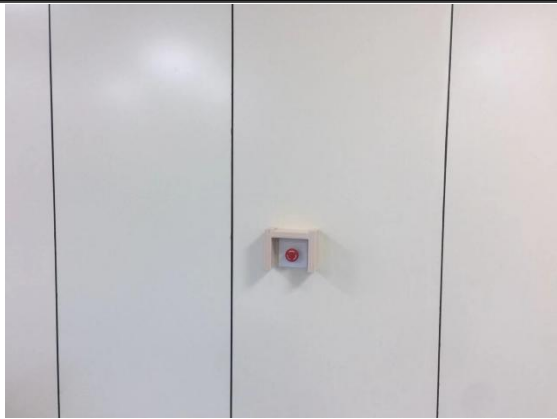
机房内急停按钮
